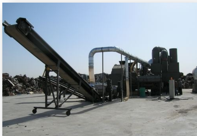
Bande d'évacuation de la ferraille
