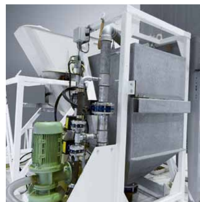
Indicateur de niveau d'eau avec pompe de vidange pour l'alimentation sous pression d'eau supplémentaire dans le malaxeur.
