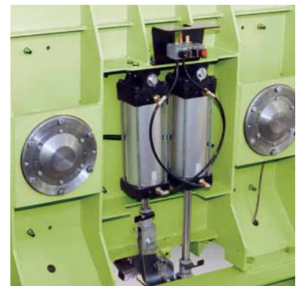
La commande pneumatique de la vanne de vidange.
