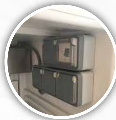
Prises électriques internes
