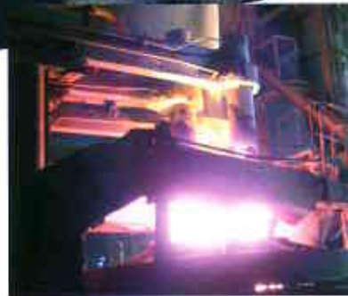
Dépoussiérage pour fours à arc dans les aciéries avec accessoires, tels refroidisseur et préséparateur d'étincelles.
