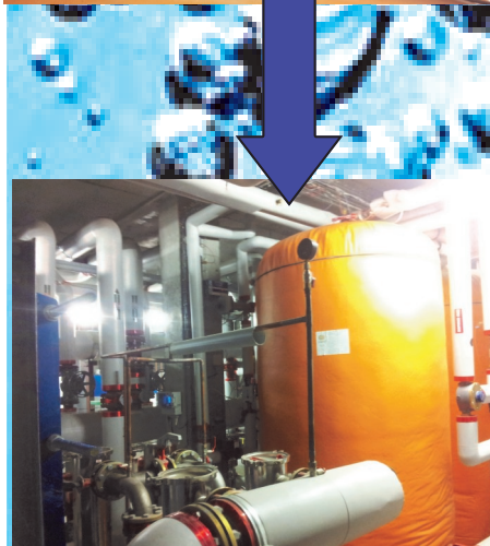
Traitement d'une boucle eau chaude sanitaire d'immeuble avec une chambre inductive inox 316L. Avant pose du calorifuge sur la bobine inductrice.
