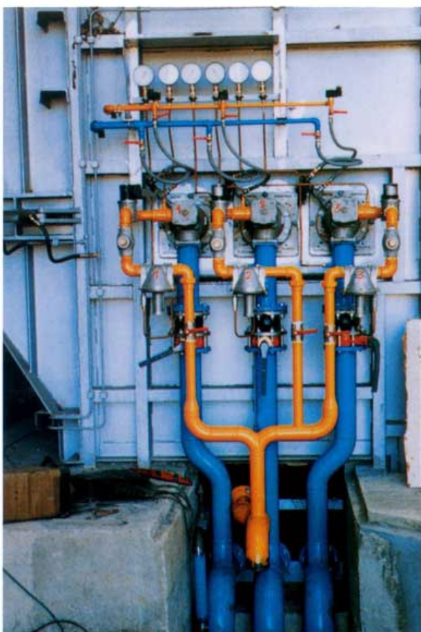
▲ Panoplie de brûleurs à Fonctionnement Séquentiel gérés par automate et initialisation de la charge.
