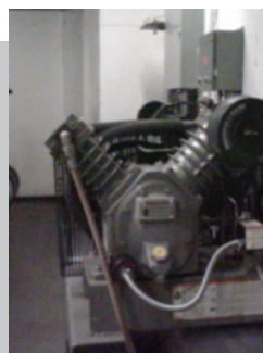
Compresseur d'air - Image visible intégrale
