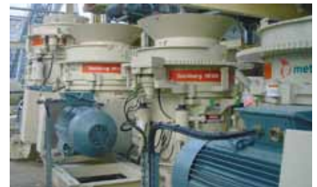
Installation fixe : un broyeur à cône Nordberg HP500, un HP300, deux HP200.
