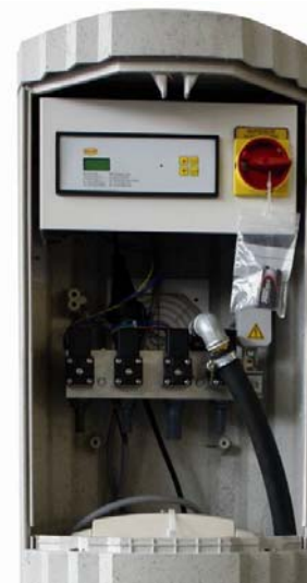
Armoire de pilotage externe ouverte
