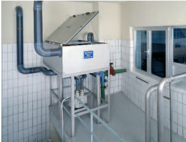
Installation de Bad Camberg : 30 m 3 /h
