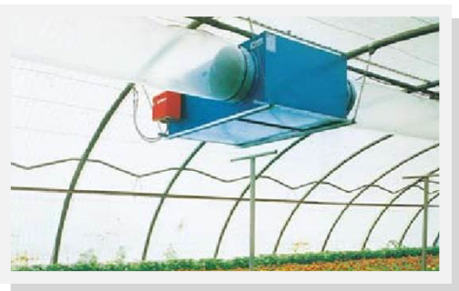
Chauffage par gaine polyane permettant une parfaite répartition de l'air chaud en serre
