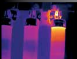
Détérioration interne du fusible
