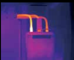
Mauvaise connexion et détérioration interne
