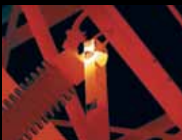
Connexion mal assurée
