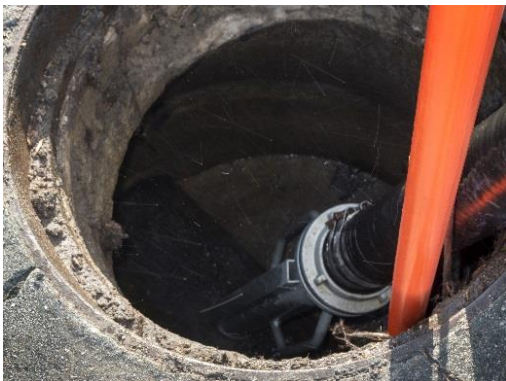
Ventilation d'un égout
