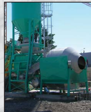
> Cuve de malaxage
