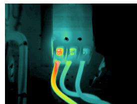
Image thermique de disjoncteur
