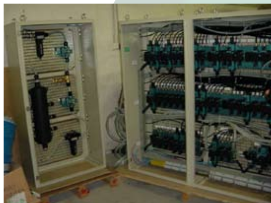
Armoire pneumatique de puissance
