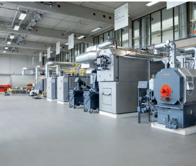
Centrale d'énergie au siège du Groupe à Allendorf (Eder)
