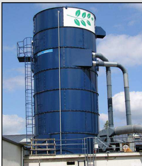
Silo de stockage
