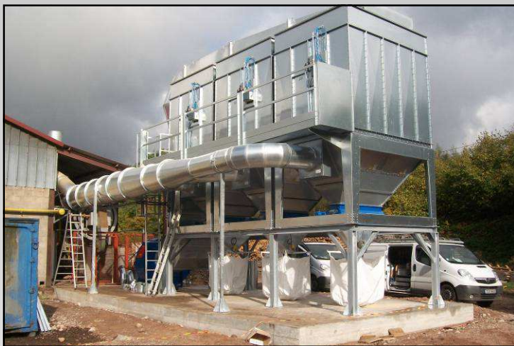
Filtere à écluse à décolmatage par air comprimé en dépression
