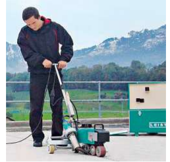
La nouvelle VARIMAT V2 à l'œuvre. Elle a été hissée directement sur le toit dans le boîtier d'appareil pratique.
