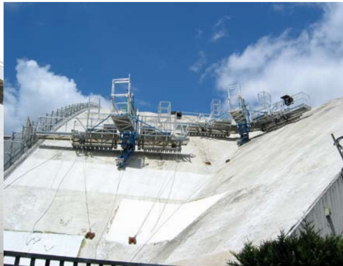
Plateforme à niveau variable pour circuler sur une voûte en béton - CNIT La Défense.
