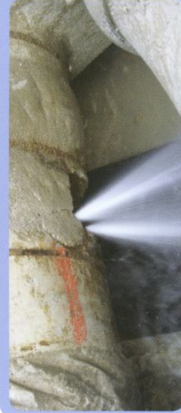
Fuite sur tuyauterie béton
