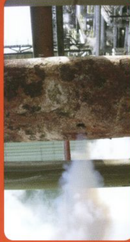
Fuite sur tuyauterie
