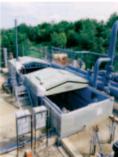
Toiture acoustique coulissante sur compresseur
