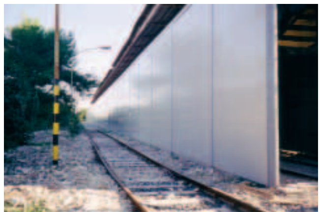
Ecran acoustique sur station d'entretien des trains
