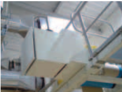
Capotage sur moteurs électriques
