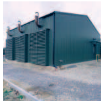
capotage acoustique outdoor sur moteurs
