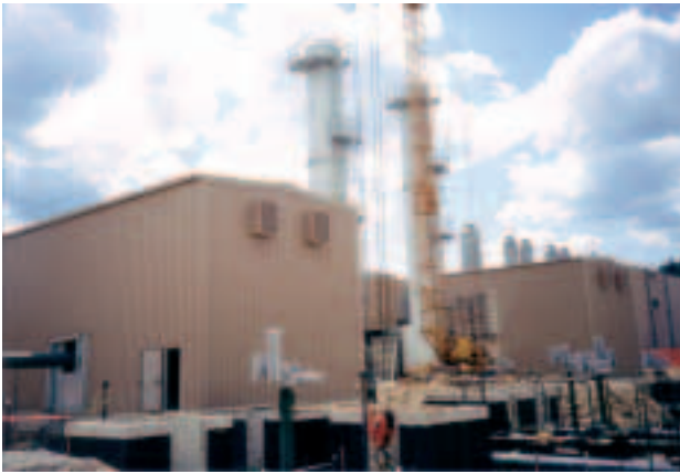
Capotage acoustique sur turbine à gaz
