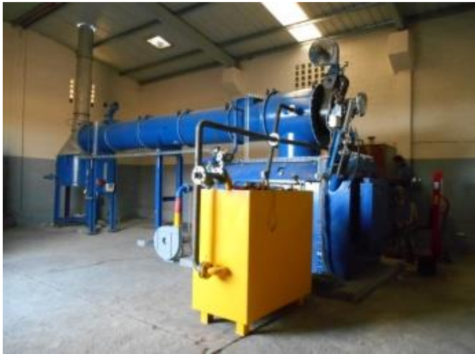
Ligne d'incineration à four statique
