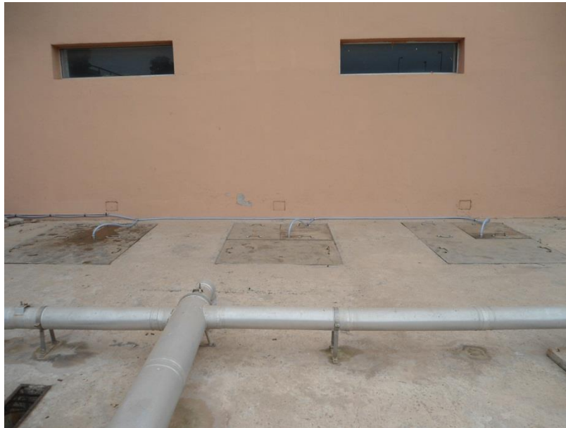
Traitement de postes de relevage à Agadir (Maroc) au moyen de têtes de diffusion
