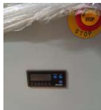
Variateur de vitesse placé sur le boîtier électrique
