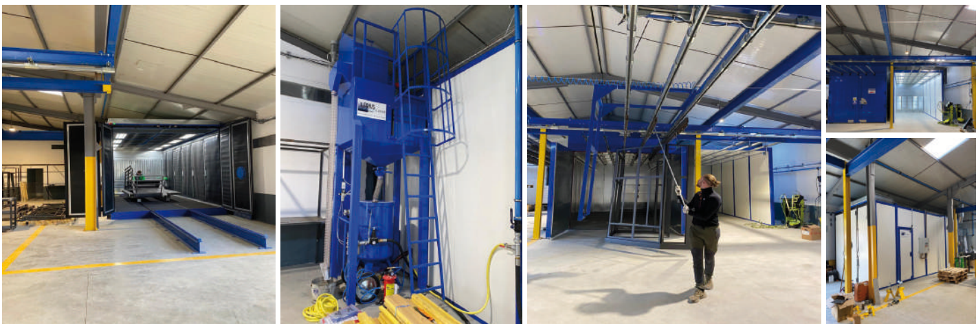
CABINE DE GRENAILLAGE - ELEVATEUR A GODET - CONVOYEUR - CABINE DE METALLISATION ET POUDRAGE
