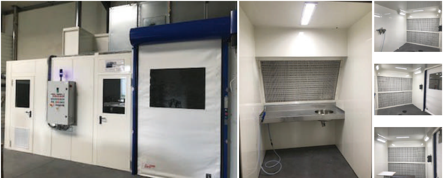
CABINE HORS POUSSIERE - LABORATOIRE DE PREPARATION - INTERIEUR CABINE
