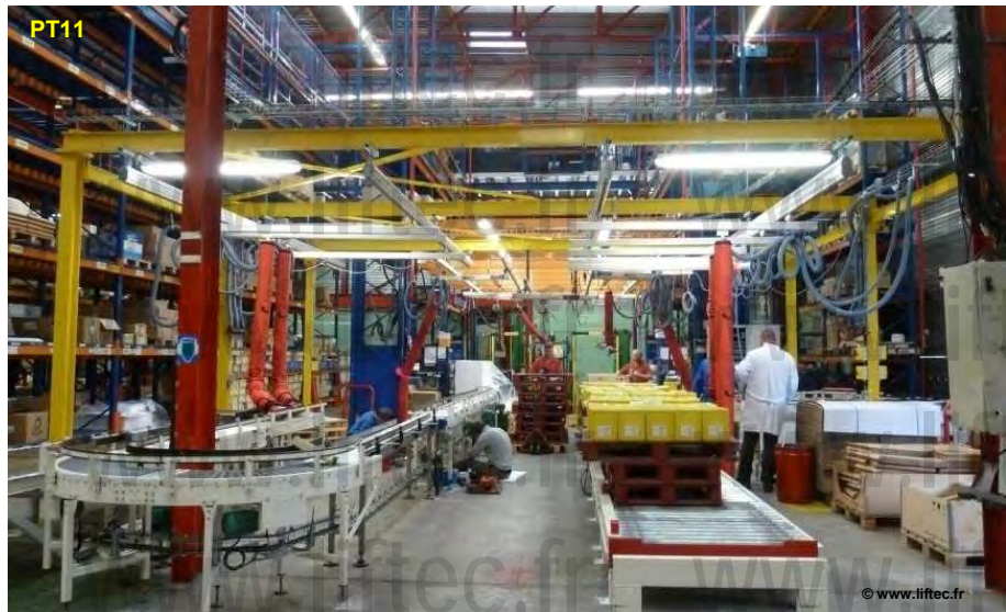
Poutre roulante + Installation VL
